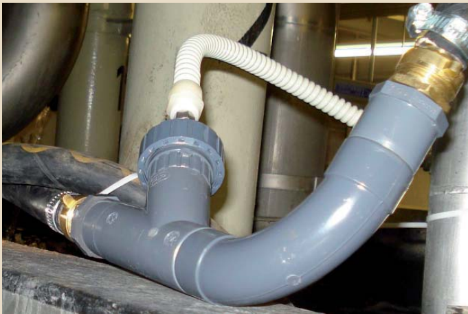
Abb. 2 PVC-Adapter mit Messsonde in der Was- serrücklaufleitung
